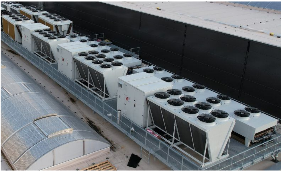
Aufsicht auf die Freikühler und PAD-Kühler (Bild: L&R).
