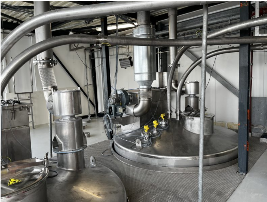
Bild der fertigen Anlage (Bild: Gericke).
