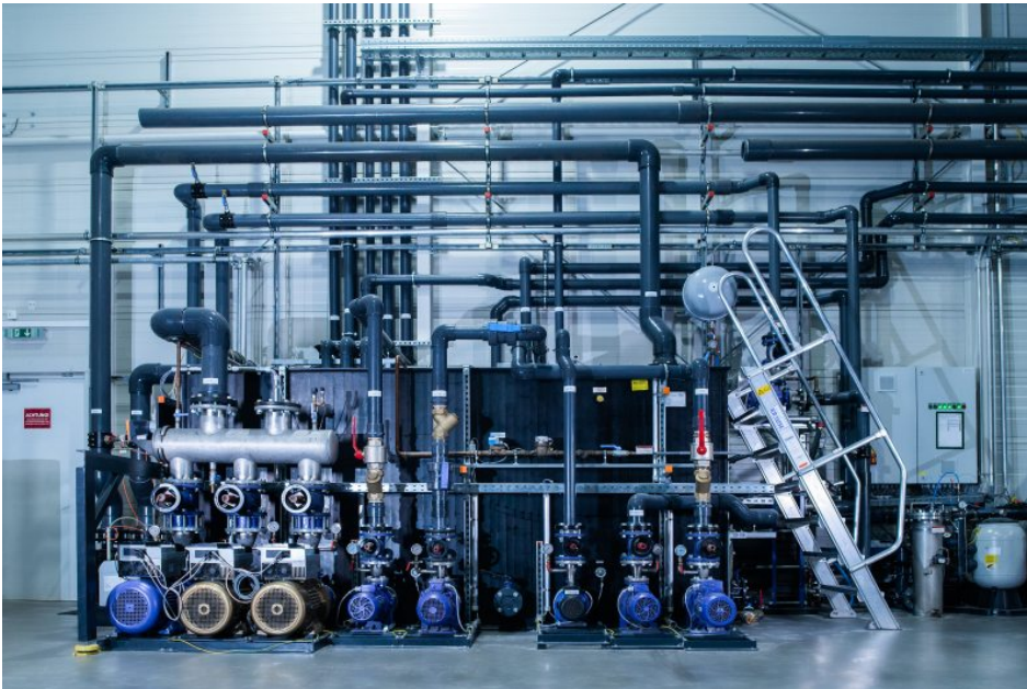
Kälteanlage für Sensoplast Packmitteltechnik GmbH, Werk Oberhonnefeld (Bild: L&R).
