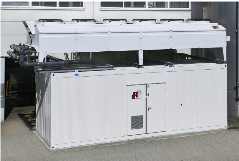
Containeranlage Außenansicht (Bild: L&R).
