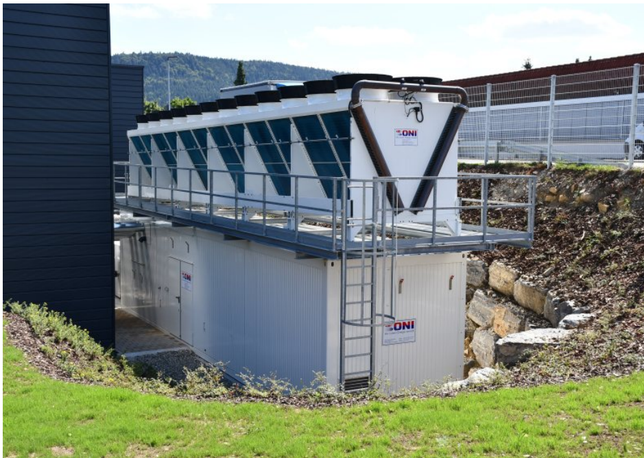
Container-Kühlanlage mit aufgesetztem V-Freikühler (Bild: ONI).
