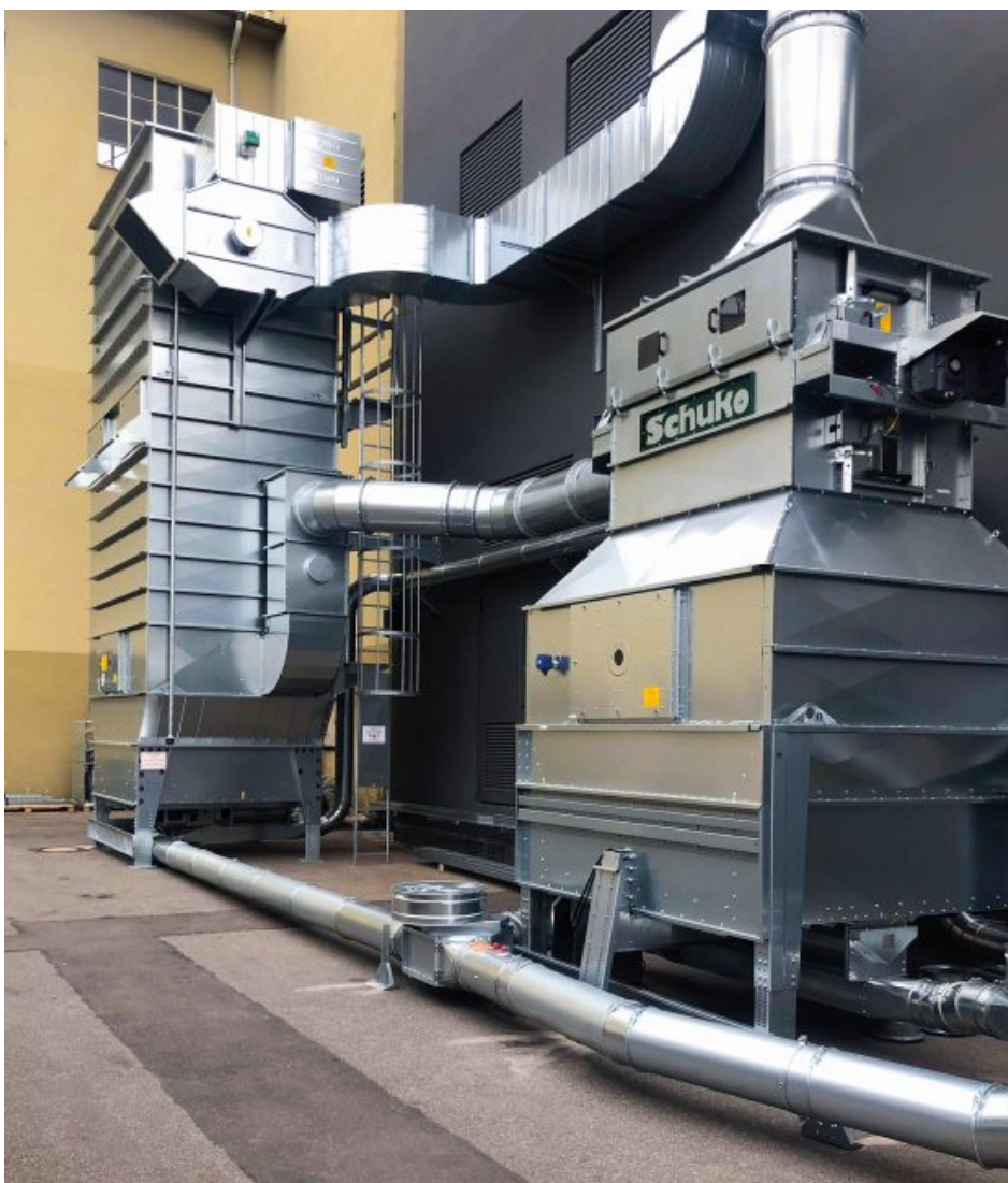
Beispiel für eine Filteranlage mit Materialvorabscheider für die Absaugung von Kunststoffspänen (Bild: Schuko).
