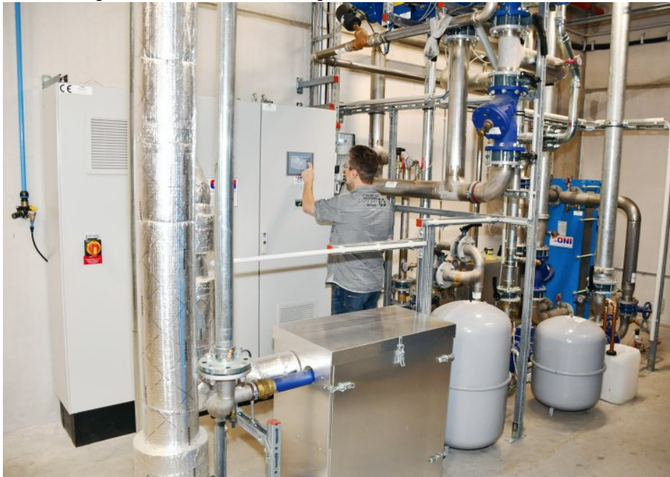
Blick auf einen Teil der Wärmetauscherstation in Bauabschnitt 2 (Bild: ONI).
