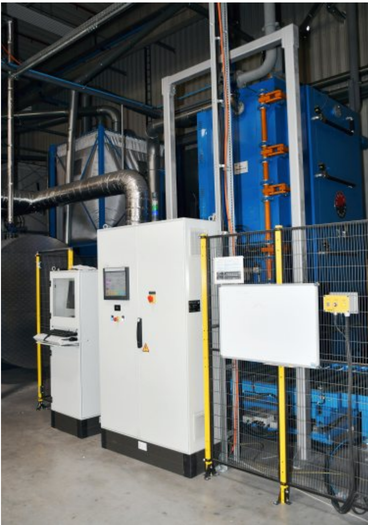
Steuerschaltschrank einer Fertigungseinheit für EPS-Dämmmaterial (Bild: ONI).
