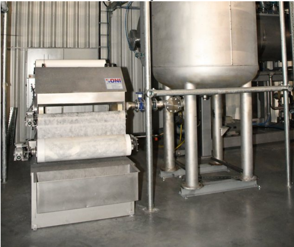
Der Rollbandfilter vor der Wärmerückgewinnung trägt dazu bei, dass unter Berücksichtigung eines Gesamtheizwärmebedarfs von etwa 1300 Kilowatt sich mit dieser Leistung 100 Prozent der erforderlichen Jahresnutzung der Heizung abdecken lassen (Bild: ONI).
