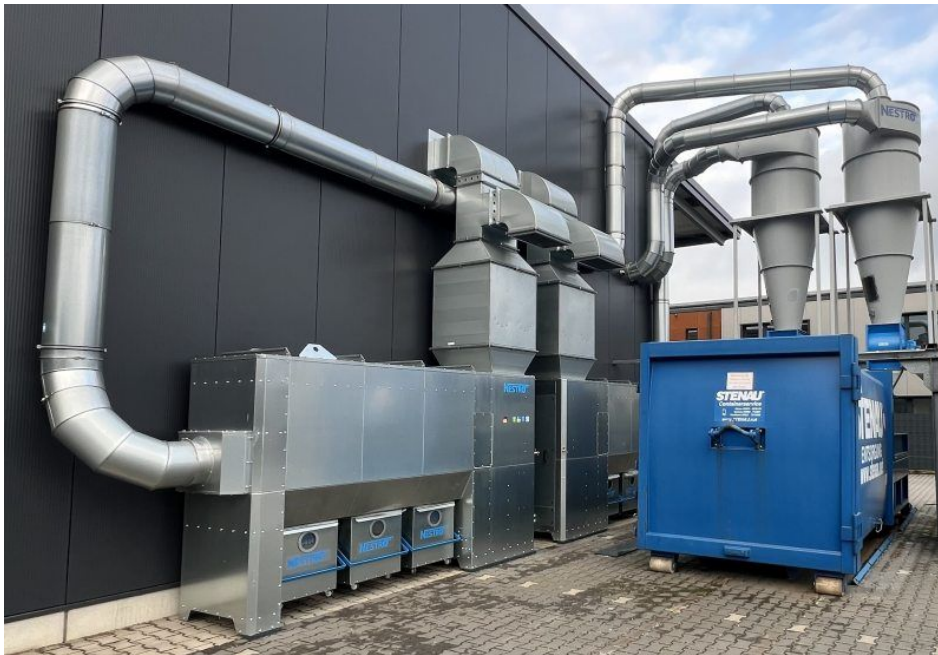
Gesamtansicht der Anlage (Bild: Nestro).
